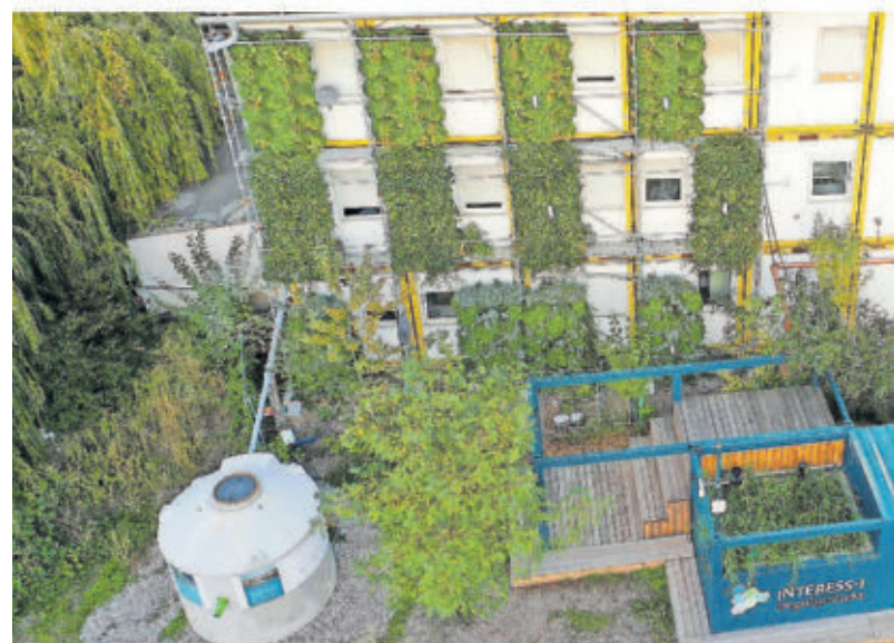
Praxisnahe Forschung: Pilotanlage für die Grau- und Regenwassernutzung zur Bewässerung. FOTO: INTERESS+PROJEKT/B. EISENBERG
